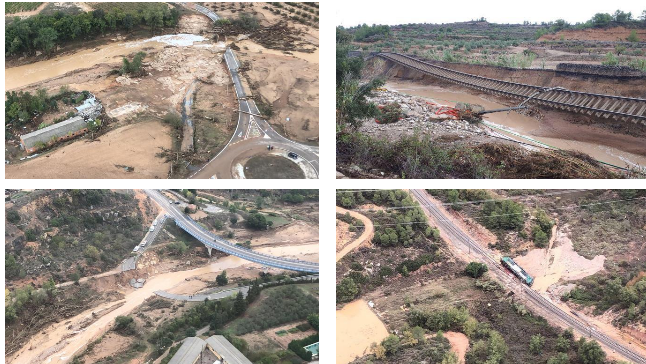
Figura 5.4. Imatges representatives de l'afectació de la gota freda del 22 d'octubre de 2019 sobre el sistema de mobilitat a les Garrigues i la Conca de Barberà.
