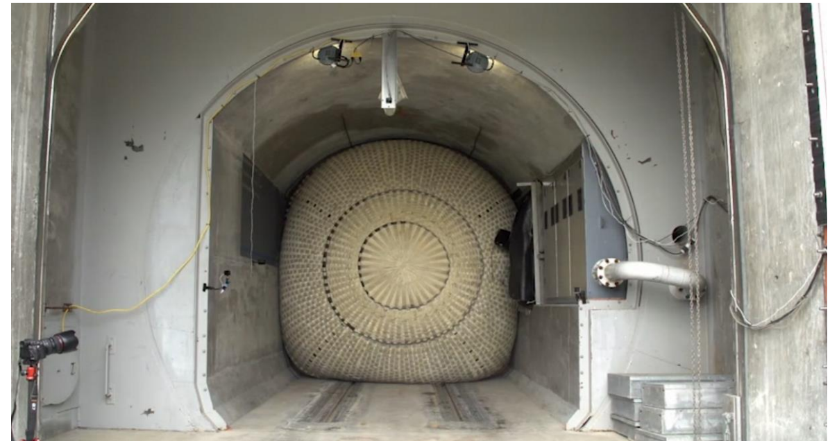
Figura 1.7. Estructura inflable per reduir les inundacions a la xarxa ferroviària subterrània.
