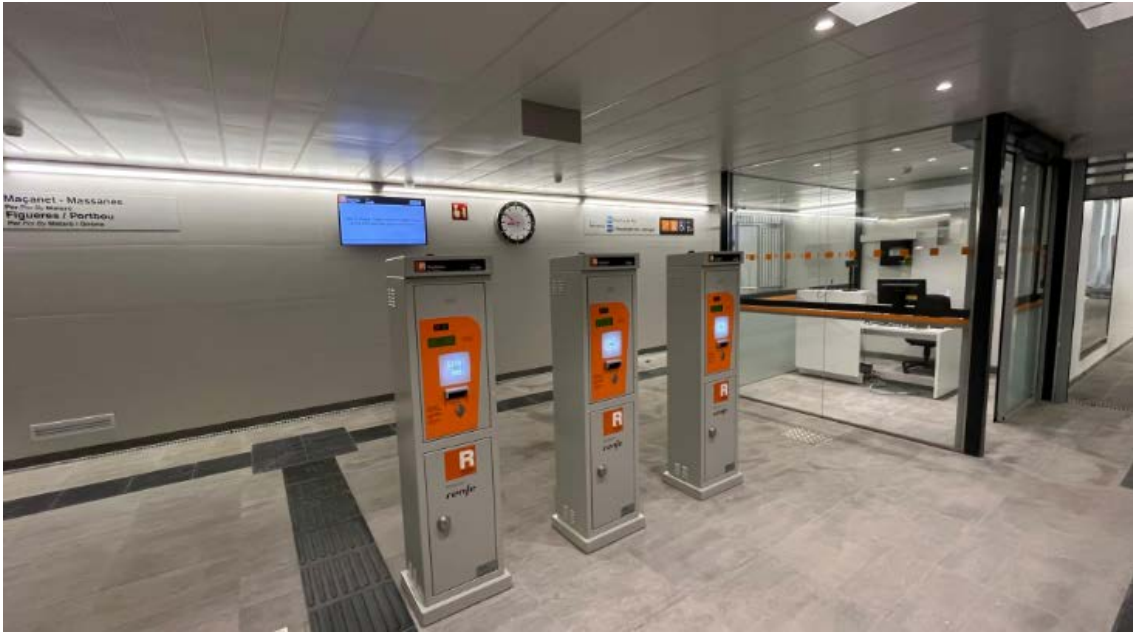
Figura 15. Control d'accés a l'estació d'Ocata
